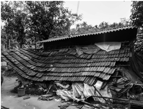
写真2 大雨によって倒壊したパニヤーンの家
